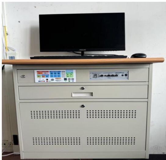
電腦設備機櫃
